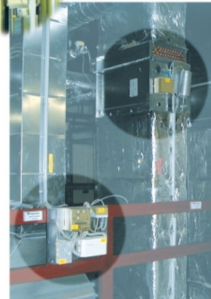
Vue d'un groupe d'alimentation et d'évacuation d'air pour une zone de salles blanches. Régulateur pneumatique-électronique et transducteurs sont rassemblés sur un panneau et reliés via des lignes tant électriques que pneumatiques avec les autres organes de mesure et de conduite.
